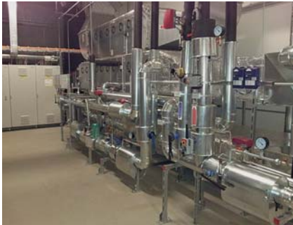
Légkezelő hűtés-fűtés oldali bekötése. Sprinkler gépház
