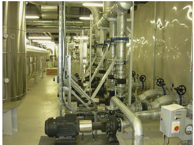
Nyitott hűtési rendszer szivattyúi az energiaközpontban
